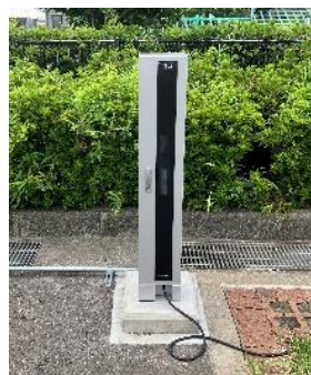
EV充電設備
