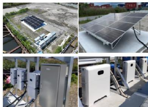
太陽光パネル・PCS・蓄電池 (陸上部)
