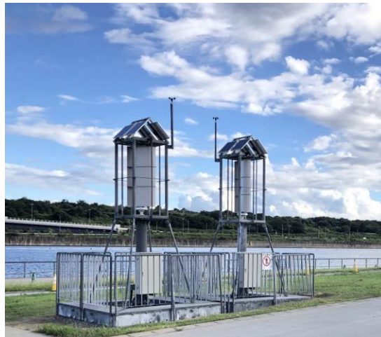
海の森水上競技場（陸上部）に設置された実証機
