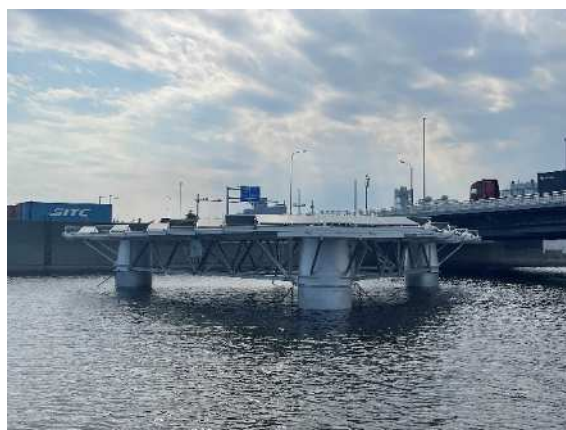
指定水面に設置された洋上浮体式太陽光パネル
