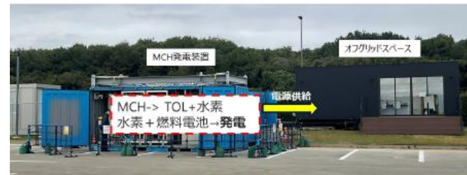
陸上MCH脱水素装置からのエネルギー供給
