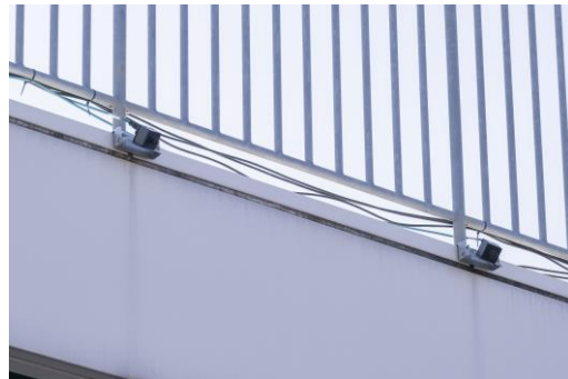
センサーカメラ (自律運行に必要な知能を インフラ側に設置)
